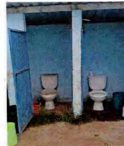
Foto4: Servicios sanitarios y sus accesorios
