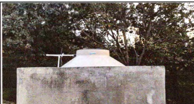
Foto1: DEPOSITO DE AGUA INSTALADO
