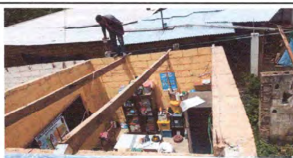
Foto: 4 Desmontaje de vigas de madera dañadas
