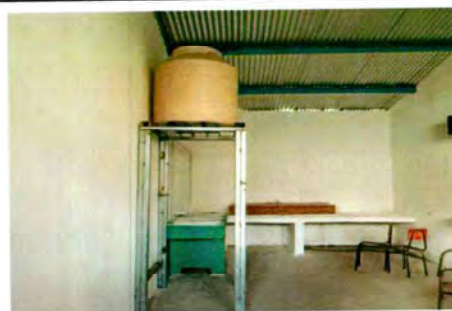
Estufa Rural, Pila y Depósito de Agua instalados en la Cocina.
