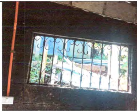
Foto 10: A la ventana no se le ha dado el mantenimiento requerido.
