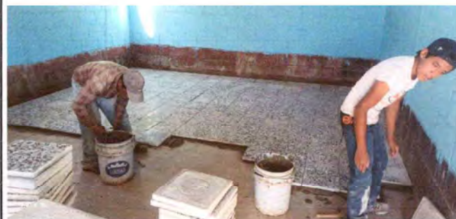
Foto 4: Se observar el cambio de piso en una de las aulas
