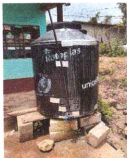
Foto 6: Se evidencia la necesidad de reparar el tinaco de almacenamiento de agua para una mejor salud
