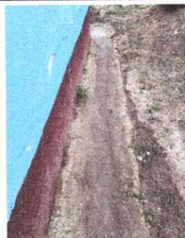
Foto 2: Se aprecia que no existen cunetas adecuadas, se construirán nuevas para que el flujo de agua pluvial sea mejor.
