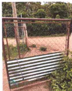
Foto 4: Se aprecia el mal estado del portón, se cambiara para mantener la seguridad del establecimiento.
