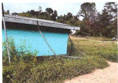
Foto 10: Se evidencia la necesidad de reparar malla perimetral, para la seguridad del establecimiento.
