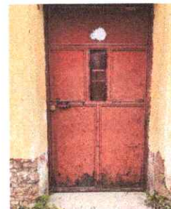
Foto 5.1: Se evidencia la necesidad de reparar puertas, para la seguridad de los niños.
