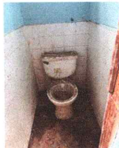
Foto 7: Se evidencia la necesidad de reparar baños, para la salud e higiene de los alumnos.
