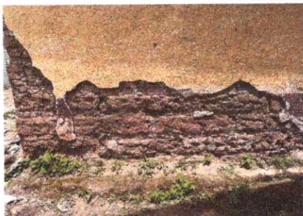
Foto 3: Se aprecia el mal estado del repello, en la pared frontal de una de las aulas.
