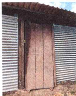
Foto 5: Se evidencia la necesidad de reparar la puerta del área de cocina.
