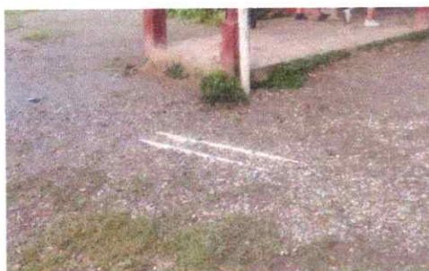
Foto 8: Red de drenajes en mal estado, se reemplazarán.
