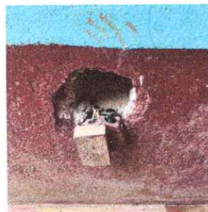
Foto 9: Se observa la necesidad de verificar las instalaciones eléctricas para su buen funcionamiento se repararán, toma corrientes, plafoneras y apagadores en global serán 17
