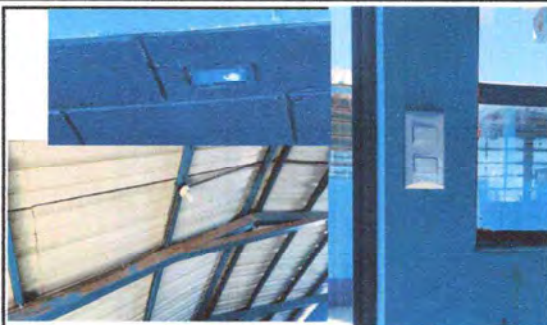
Foto 7: Sistema eléctrico instalado por completo
