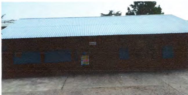
Foto 3: el techo fue cambiado en su mayoría
