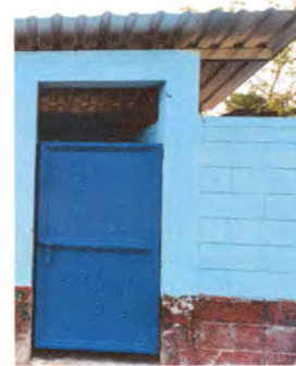
Foto 2: se puede observar que las puertas del baño fueron cambiadas
