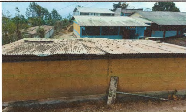
Foto3: El techo ya se encuentra oxidado
