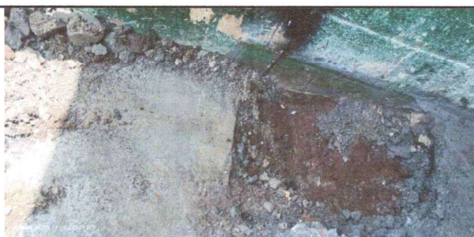
Foto 5: SE OBSERVA DONDE SE QUITO EL SANITARIO
