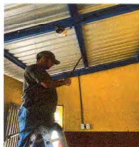
Foto 8: SISTEMA ELECTRICO (tomacorrientes e interruptores)
