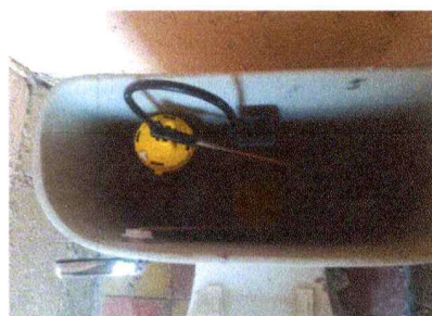
Foto 4: SERVICIOS SANITARIOS Y ACCESORIOS
