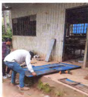
Foto 3: SE OBSERVA PINTADO DE PUERTA EN MAL ESTADO
