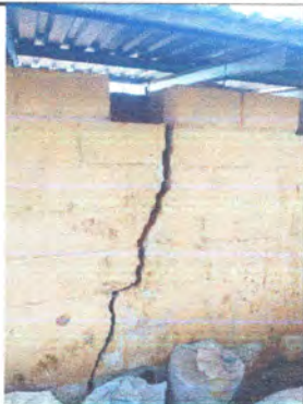
Foto 1: Pared de sanitarios en mal estado.
