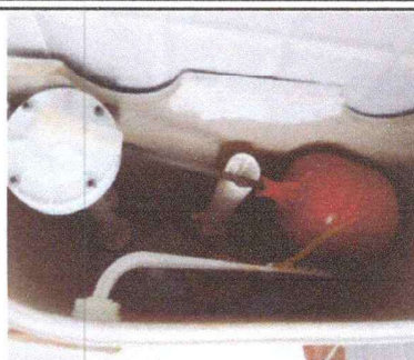
Foto 2: ACCESORIOS DE BAÑOS
