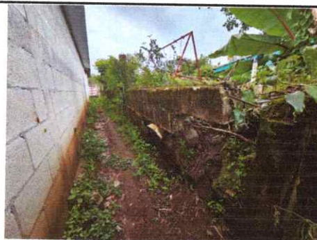
Foto 4: Se evidencia la necesidad de reparar muro lateral, para evitar accidentes a los alumnos del establecimiento.
