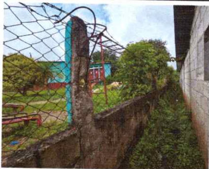
Foto 1: Se aprecia el mal estado de la malla, se reparará para mantener la seguridad del establecimiento.
