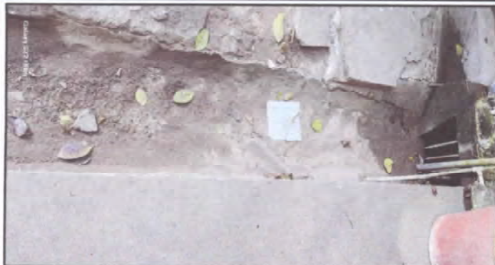
Foto 7: Cuneta de concreto en mal estado.
