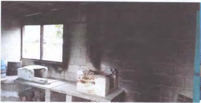
foto 12 sustitucion de estufa rural completa
