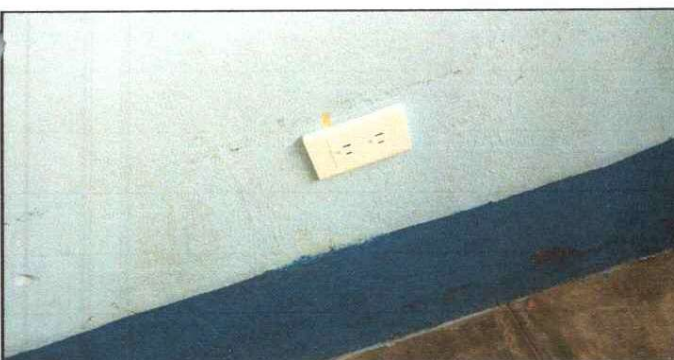
TOACORRIENTES NUEVOS INSTALADOS
