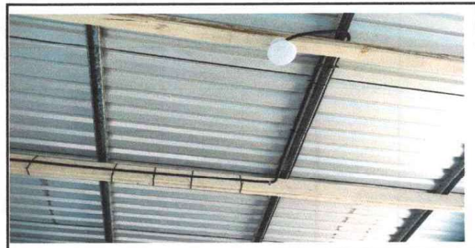
SISTEMA ELÉCTRICO INSTALADO
