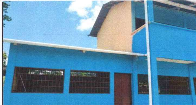
SISTEMA DE AGUA PLUVIAL COMPLETA E INSTALADA
