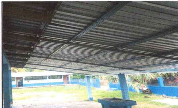
ESTRUCTURA DE COSTANERA Y LÁMINA TROQUELADA ALUZINC
