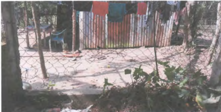
Partes de la malla se encuentran dañadas.
