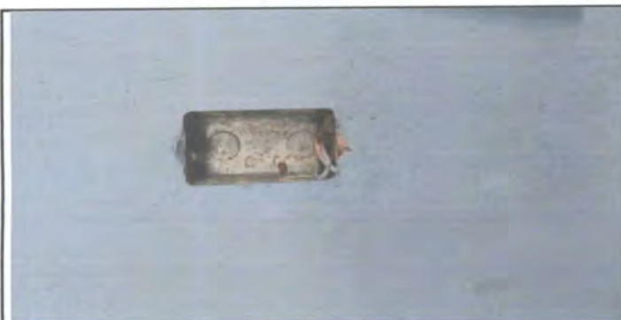
No se cuenta con tomacorrientes ni interruptores.
