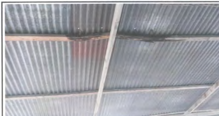
El soporte por ser de madera se pudrió y la lámina está agujerada.
