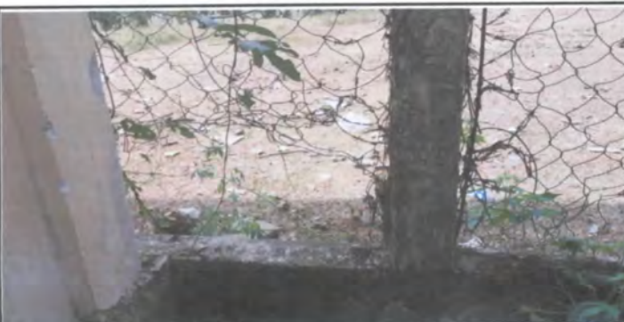
Espacios Faltantes de malla.
