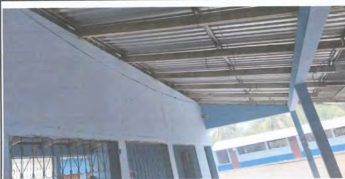
Sistema eléctrico careciente nulo en algunos espacios.
