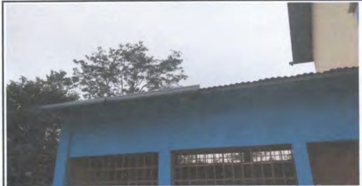
Canaletes Incompletos y dañados.
