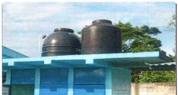
Foto 6: Deposito de agua 1,100 litros
