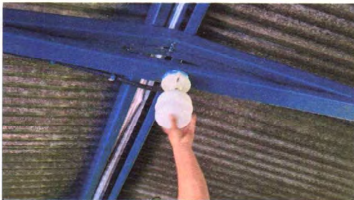
Foto No.9. Sustitución de Lámparas tipo Led
