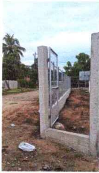
1. Daño en las columnas del cerco / muro perimetral.
