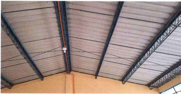
3. Deterioro de Sistema eléctrico.
