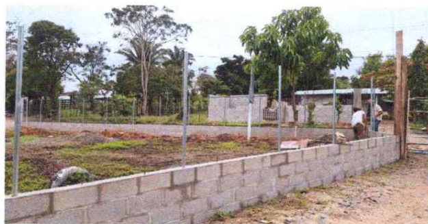
2. Daño por sectores en el cerco / muro perimetral.
