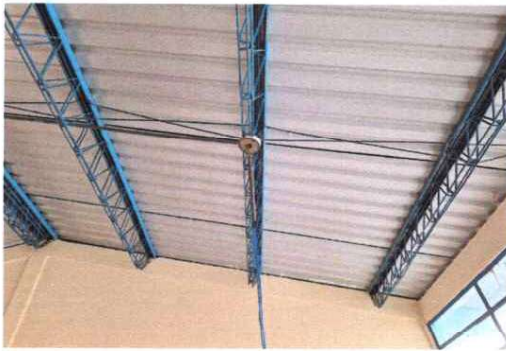
3. Deterioro de Sistema eléctrico.
