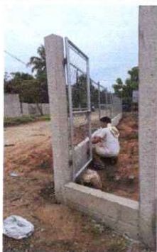
1. Daño en las columnas del cerco / muro perimetral.
