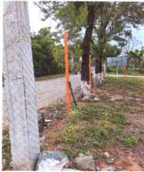
1. Daño en las columnas del cerco / muro perimetral.
