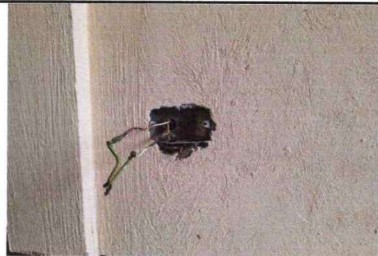
4. Daños en el sistema de toma de corriente.
