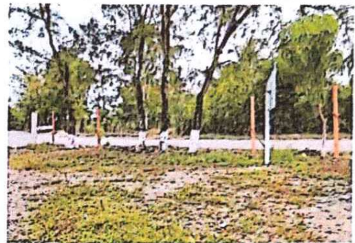
2. Daño por sectores en el cerco / muro perimetral.
