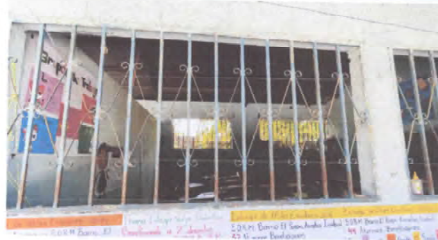
Foto 4: Sustruciones de Balcones de metal.
