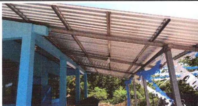
Estructura de techo de madera por metal.
