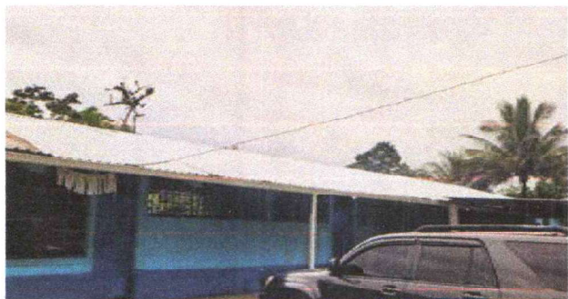
FOTO 11: TECHO EN MAL ESTADO
