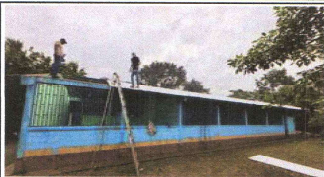
FOTO 6: TECHO MAL ESTADO
