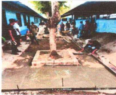
Foto1: Plancha de concreto en patio trasero
