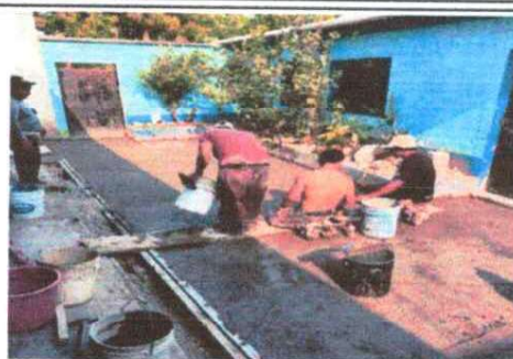
Foto 2: Plancha de concreto de patio delantero
