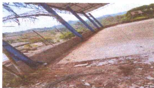
asi queda la tuberia de reposadera del agua de la caida de la lamina
