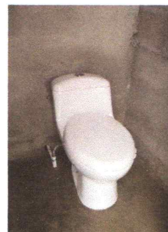
Foto 4: Sustrucion de inodoro
