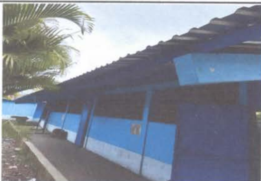
Canales y Bajas de Agua Pluvial
