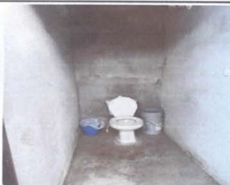
Servicio Sanitario Lavamanos
