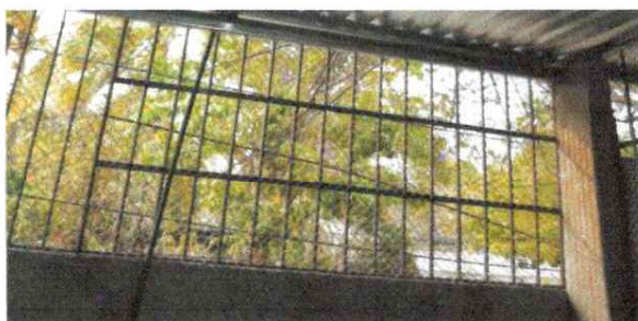
VENTANA , PUESTA DE BALCON PARA SEGURIDAD EN COCINA
