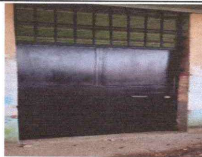
Foto 20: Sustrucción de puerta
