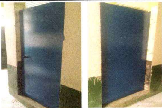
Foto1: Sustrucción de puerta, aulas y sanitarios
