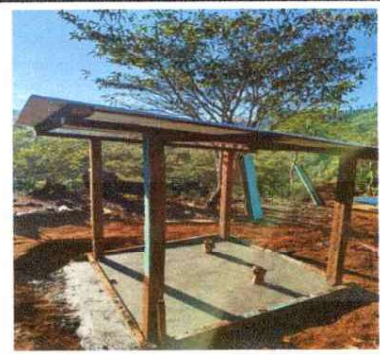
Foto 6: Entechado del servicio sanitario
