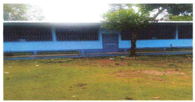
Foto 6:PINTADA EN MUROS EXTERIORES.
