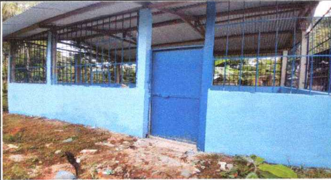
Foto 7: REPELLO DE MURO EXTERIOR.
