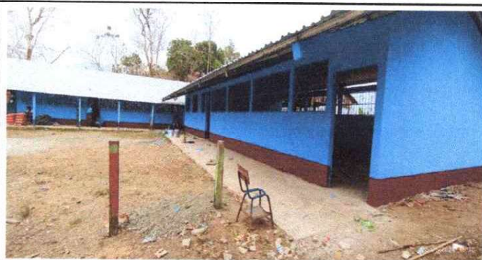
FOTO 6: PINTURA EN MURO EXTERIORES.
