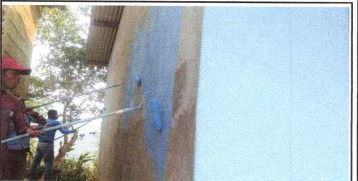
FOTO 6: PINTURA EN MURO EXTERIORES.
