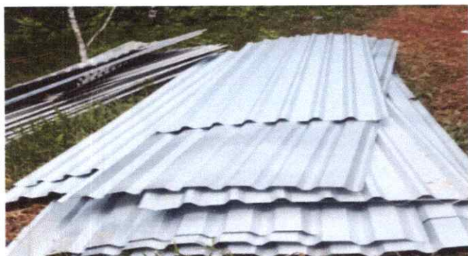
Lamina que se desinstalo del techo de la Escuela
