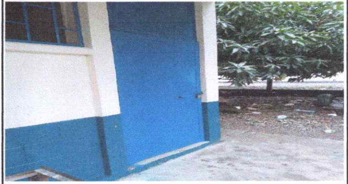
FOTO 2: Sustrucción de puerta
