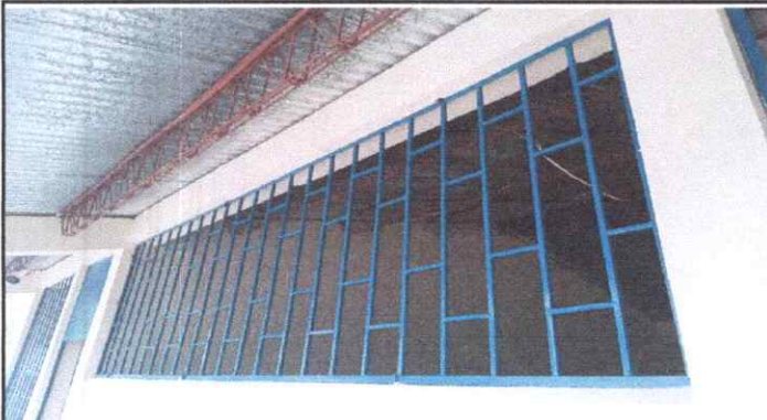
FOTO 3: Sustrucción de estructura de metal de ventana
