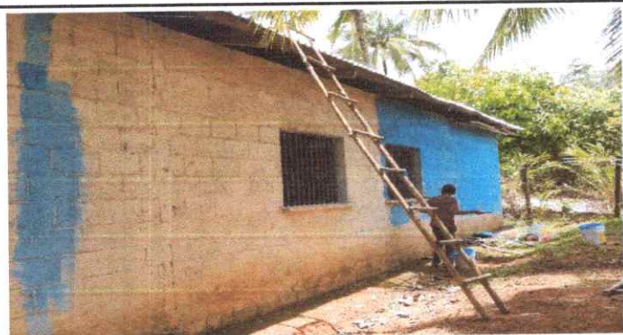
5. Pintura en muro exterior
