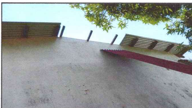
Foto 4: Sustrucción de lámina, aula de tercero A
