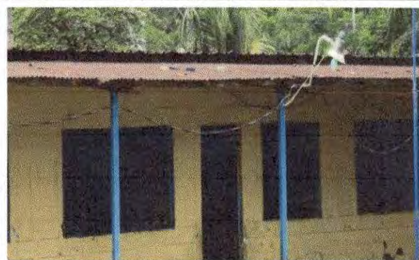
Foto 4: MODULO "A" AULAS REMOZAMIENTO LAMINA
