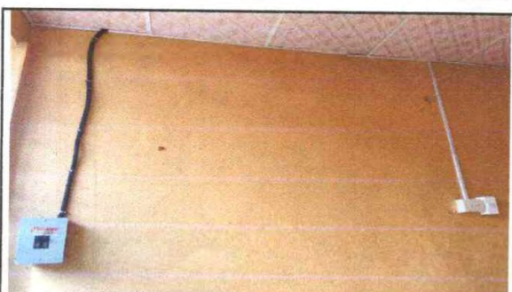
SISTEMA ELÉCTRICO INSTALADO CORRECTAMENTE
