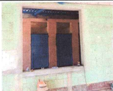
FOTO 09: REPELLO DE LAS VENTANAS DE LA BODEGA.
