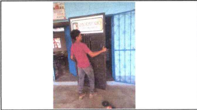
FOTO 03: REEMPLAZO DE PUERTA EN MAL ESTADO
