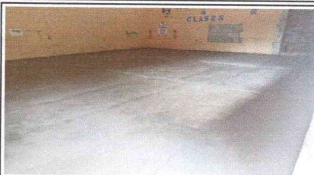
Foto 2: Piso de torta de cemento en aula uno, dos y tres.
