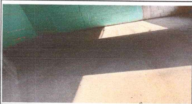
Foto 1: Piso de torta de cemento en aula uno, dos y tres.
