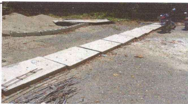
Foto 4: Tapaderas de concreto para cuneta.
