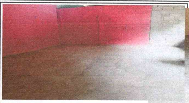
Foto 2: Piso de torta de cemento en aula dos .
