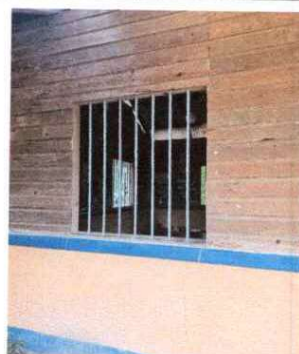
Foto 4: Ventanas en mal estado
