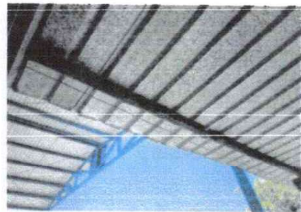
Foto No.4: Carga láminas oxidadas
