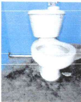
Foto No.3: Inodoros quebrados
