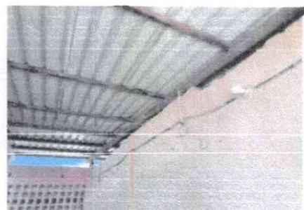
Foto No.6: Techo en mal estado (filtraciones)
